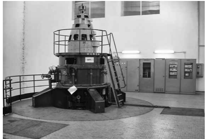
Figura 18 bis, Gruppo turbina Francis reversibile ad asse verticale-alternatore da 95 MVA, centrale idroelettrica, con pompaggio, del Taloro (NU). Fonte immagine http://www.ingdemurtas.it/energia/taloro/
